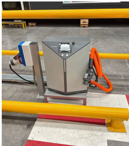
Bodega. Cargador de baterías para grúas horquilla en zona de carga.
