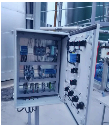
Control de 2 bombas. Tablero con mando manual y automático.
