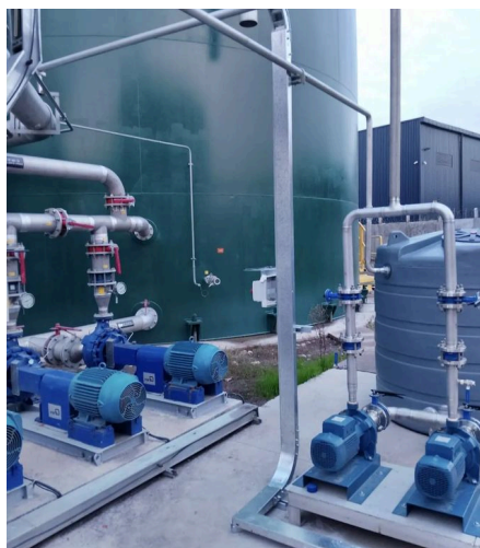
Terreno. Las 2 bombas comandadas desde ese tablero.
