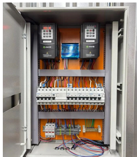
Agroindustria. Tablero con 2 variadores para línea transportadora de envasado de uva.
